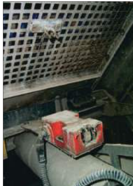
Figura 7: Interblocco esposto a condizioni ambientali severe
